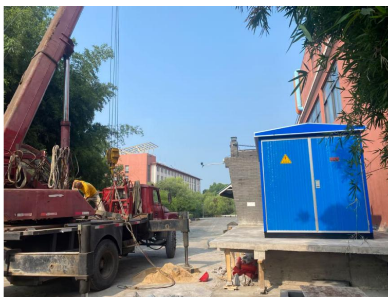
图 7-5-1 食堂气改电工程项目
